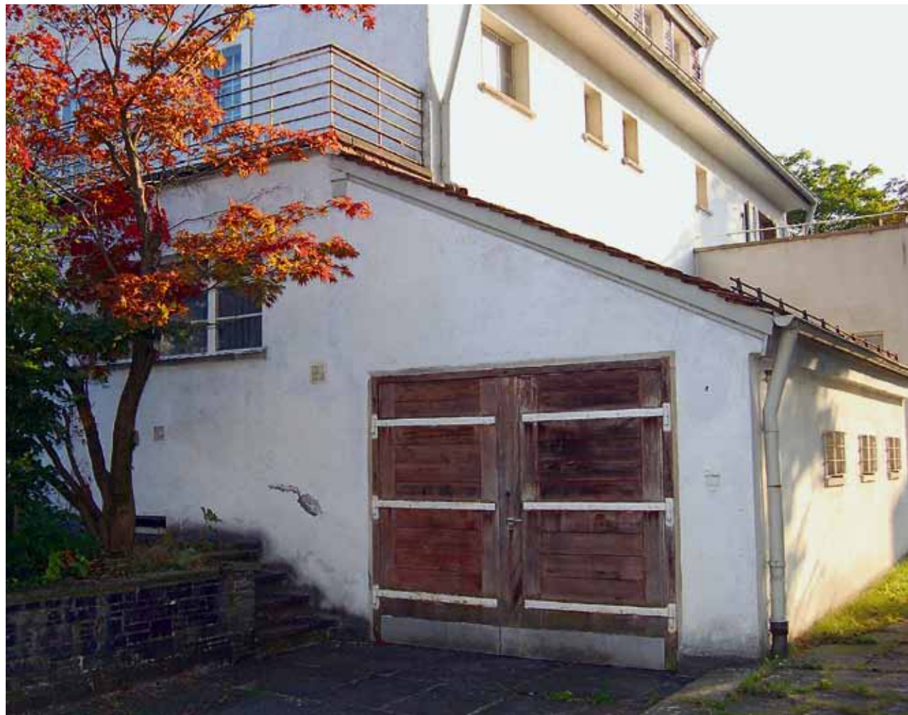
Spuren der Zeit an allen Ecken und Enden: Ein gut ausgearbeitetes Sanierungskonzept ist auf jeden Fall die Grundlage für ein optimales ökonomisches und energetisches Vorgehen.
