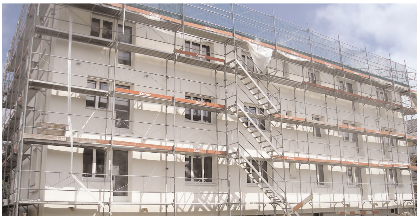
Eine sorgfältige und gut geplante Bauabnahme lässt fehlerhafte Ausführungen frühzeitig erkennen.
