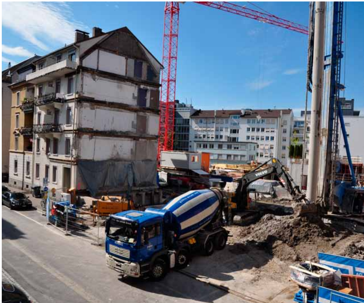
Von Bauarbeiten verursachte Erschütterungen können Risse an Nachbargebäuden verursachen.
