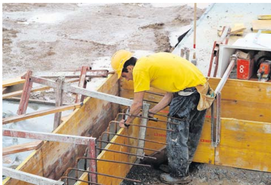
Baumängel müssen rechtzeitig erkannt und beanstandet werden. Laien sollten für die Baukontrolle deshalb besser einen Fachmann beiziehen.
