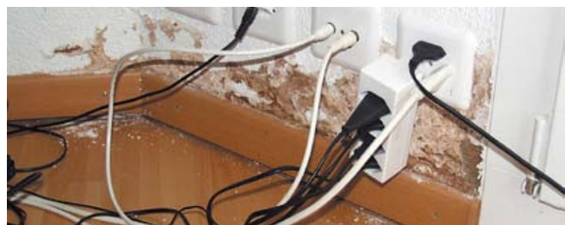
Gefährlich: Wassereintritt unterhalb einer Stromleiste.
